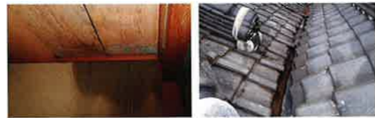
瓦の隙間から雨が入り、天井や壁に雨漏りが起きていた。
